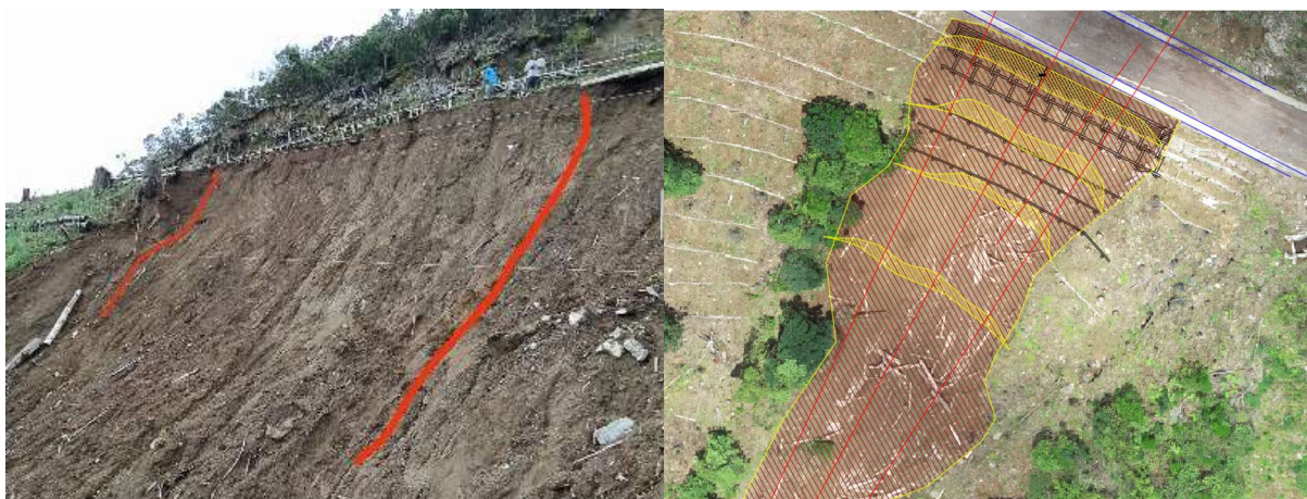
Figura 42. Visão da destruição causada pela depressão Óscar a 5 de junho de 2023 no talude de enchimento onde se localizava o muro-vivo por patamares.
