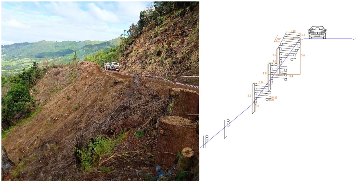
Figura 40. Visão da área em risco de colapso em agosto de 2022, e esquema da intervenção proposta para o local.
