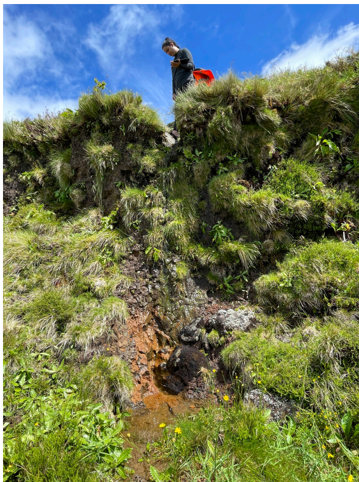
Fig. 25. Vala de drenagem que evacua as águas para uma zona com derrocadas preexistentes, aumentando os riscos do colapso do terreno.
