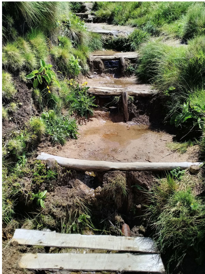
Fig. 24. Degraus comprometidos pela erosão hídrica. A água é desviada para a encosta, aumentando o risco de derrocada já existente.
