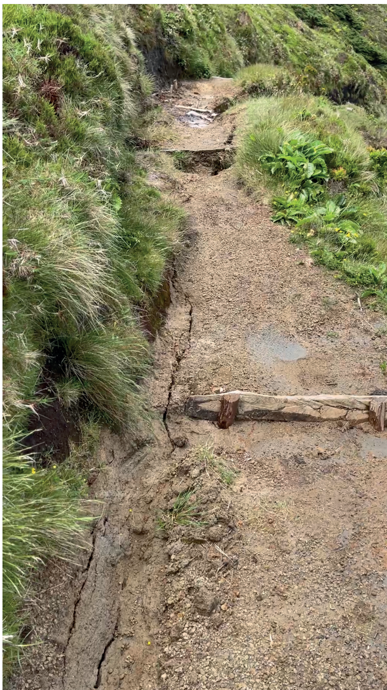
Fig. 27. Fissura no trilho ligada à derrocada preexistente.
